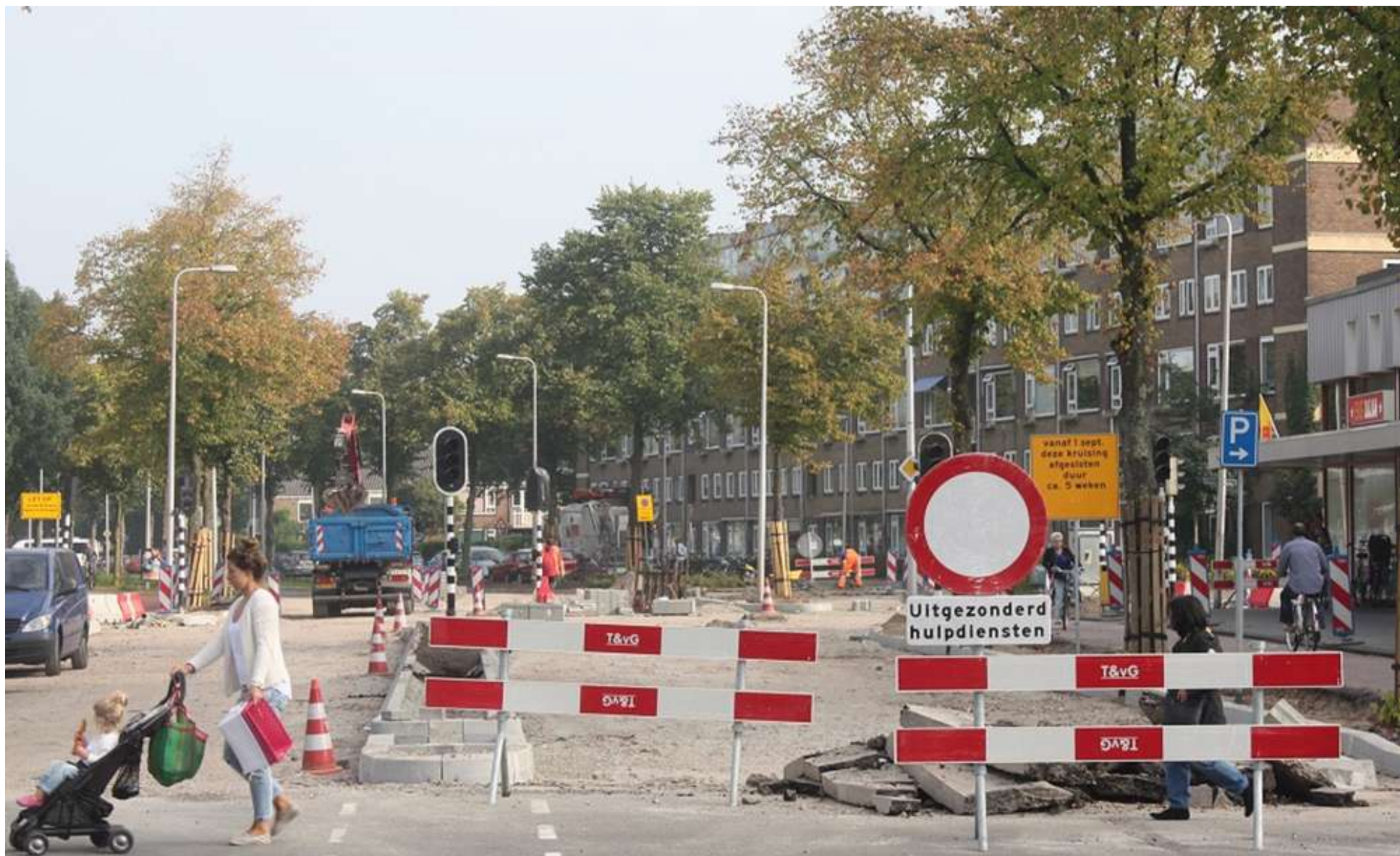
FOTO EVELIEN BALJET - De laatste fase van het groot onderhoud aan de Briljantlaan in de wijk Tolsteeg is in volle gang. Deze laatste fase betreft het einde van de Briljantlaan en het eerste deel van de W.A. Vultostraat, tussen het Smaragdplein en Aquamarijnlaan. Eind mei startte de gemeente met de werkzaamheden aan de Briljantlaan. Half oktober zijn de werkzaamheden klaar en is de Briljantlaan weer voor al het verkeer toegankelijk. Het asfalt wordt vervangen en er komt een groene middenberm en de zijbermen worden beplant. De aanpak van de Briljantlaan is onderdeel van de wegwerkzaamheden in de omgeving van Vaartsche Rijn.
